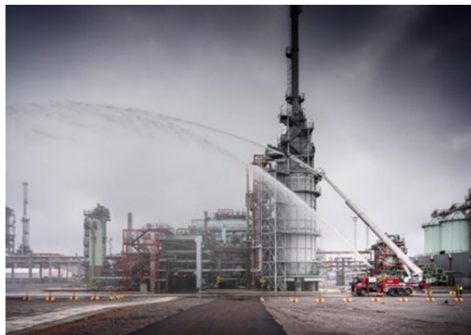
Obrázok 3. Vodná, penová veža na priemyselné hasenie požiarov pri zásahu (model Bronto F-WTF) [8]
