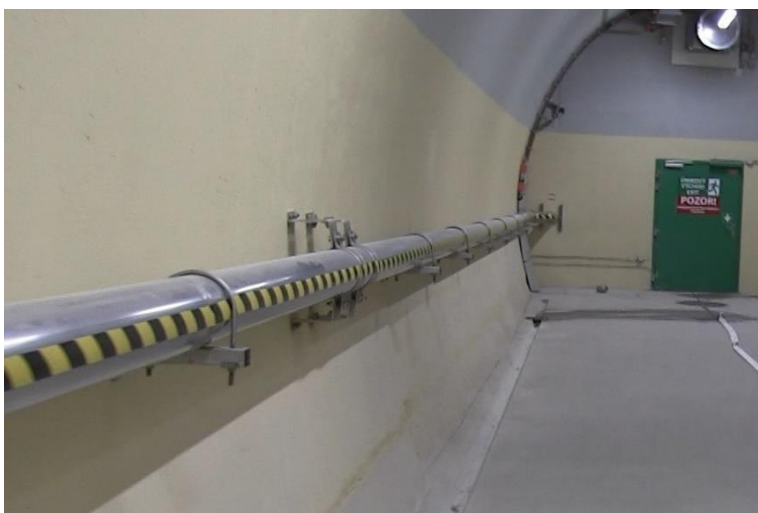
Obr. 15 Nezavodnený požiarny vodovod v priečnom prepojení (Zdroj: Autor)
