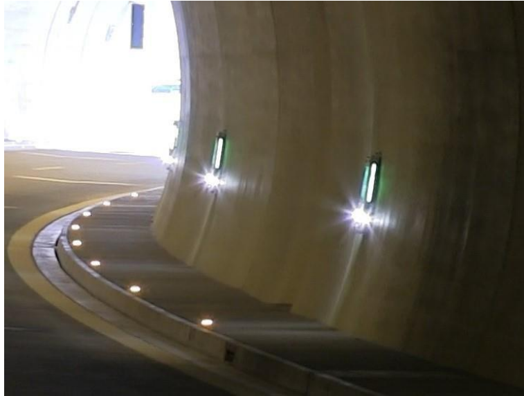
Obr. 23 Svietidlá požiarneho núdzového osvetlenia (Zdroj: Autor)
